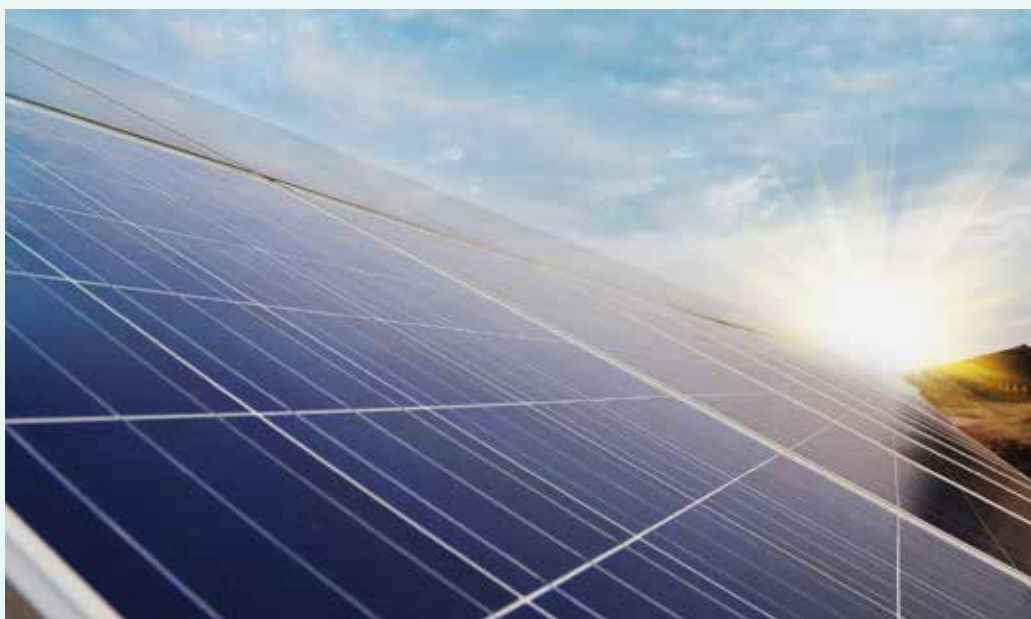
Auf dem neuen Werkhofgebäude ist eine Photovoltaik-Anlage installiert worden.
